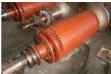
Gambar 4.4 Kondisi Rotor setelah Overhaul
