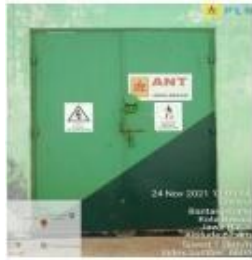
Gambar 4. 1 Gardu ANT Pada P. Rawa Pasung Sumber : Dokumen Pribadi
