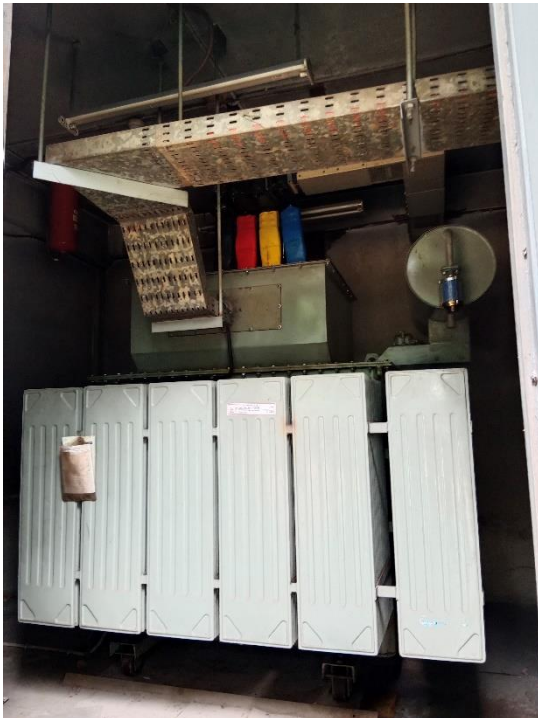
Gambar 8 Transformator yang ada pada PT Sintas Kurama Perdana
